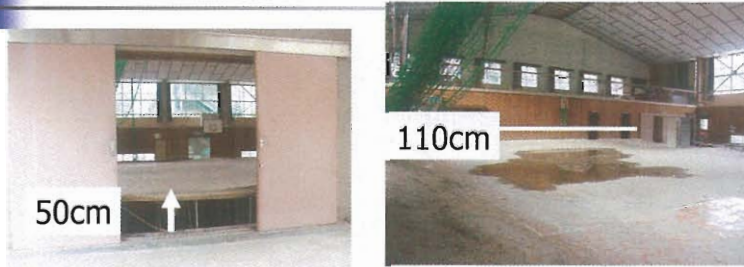
写真1 2005年台風14号により浸水した美川小中学校共用体育館(旧避難所指定場所)
